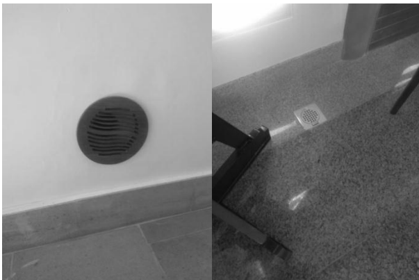
Gambar 9. Outlet pada dinding ruang umat dan pada lantai altar.
