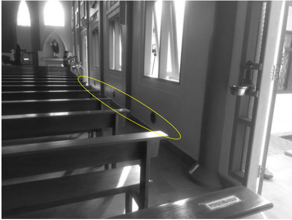
Gambar 8. Outlet pipa pendistribusi udara pada dinding sisi utara.
